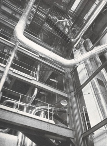
UNA VEDUTA dell'interno della centrale termoelettrica di Civitavecchia della S.E.T.
