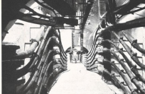
SME - Particolare della galleria cavi dell'impianto del Marone.
