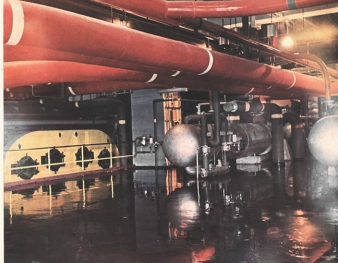
FRIGERISCALDATORI dell'acqua di alimentazione delle caldole e relative tubazioni della centrale termoeletttrica Sip di Chivasso.
